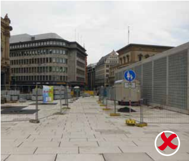
Bild 3 | schlecht sichtbare Abspernung
